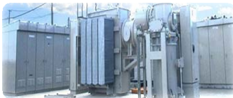
写真1.5-5 二次変圧設備（イメージ）
