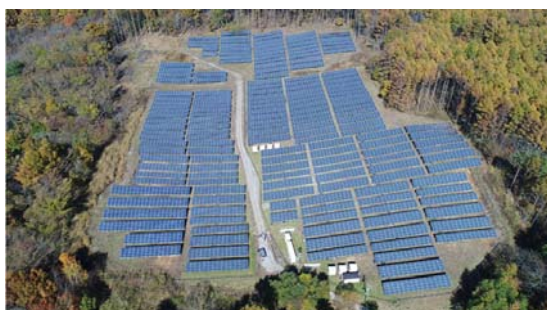
計画地北東側の発電所
