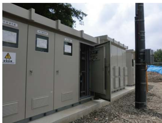
一次変電設備
