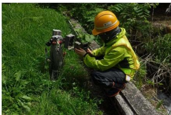
写真 5.2.1.7 上流部センサーカメラのメンテナンス
