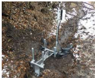
パージアルリュウム式流量計による流量連続調査
