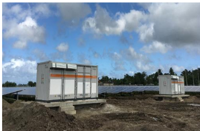
写真 1-6-2 パワーコンディショナー及びサブ変電設備（イメージ）
