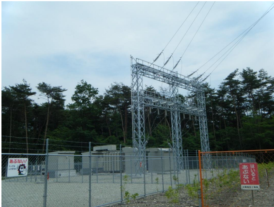
写真 1-6-3 送変電設備及び門型鉄構（イメージ）
