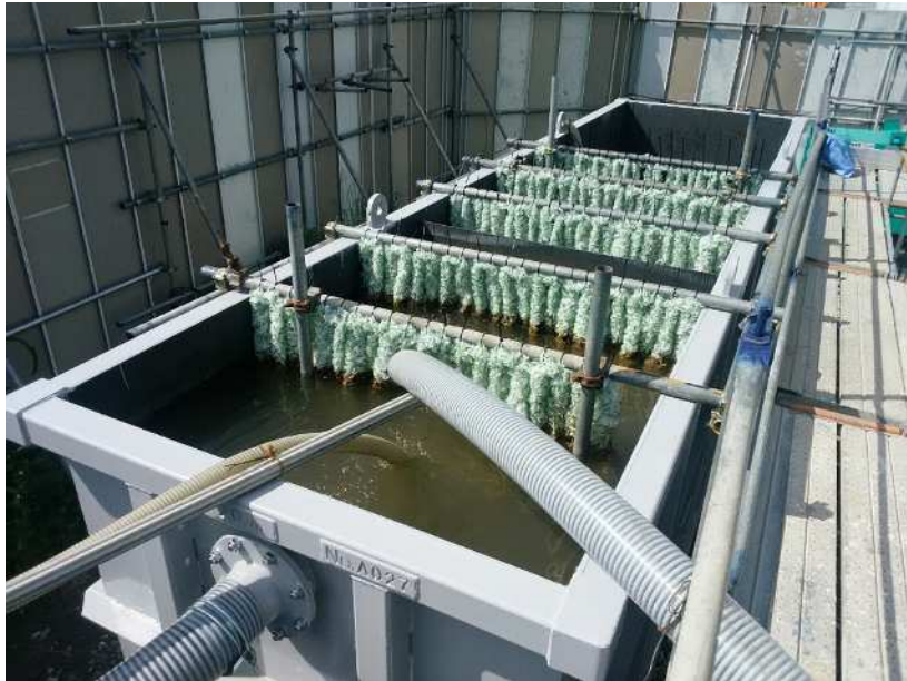
排水処理状況②
