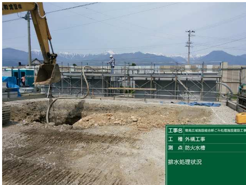
仮設処理水槽 全景
