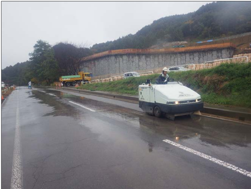
写真区分:環境対策 工種:環境コンサル(6) 種別:工事用車両出入口の路面洗淨 写真タイトル:機械清掃状況 撮影箇所:現場出入口道路
