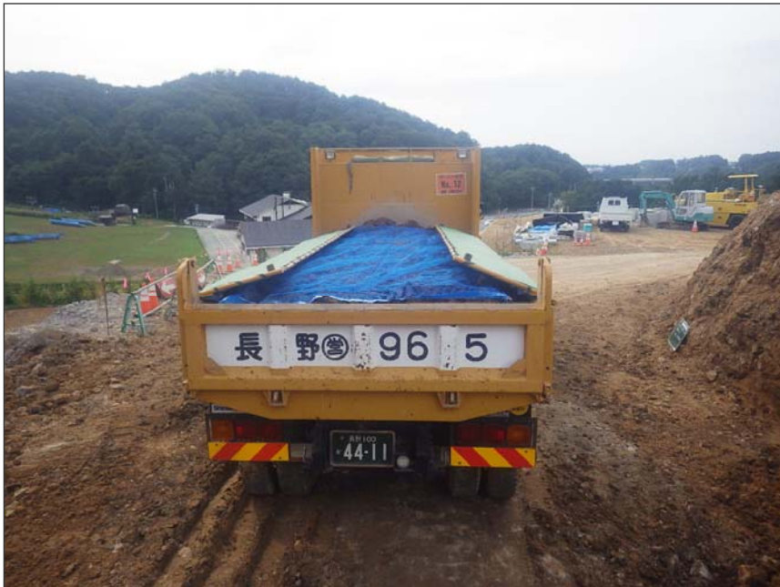
写真区分:環境対策 工種:環境コンサル(5) 種別:土砂運搬車両飛散防止 写真タイトル:荷台シート養生 撮影箇所:現場にて
