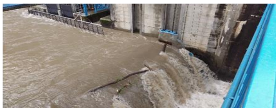
図 21 流木と濁度上昇時の取水口
