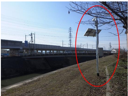
簡易型河川カメラの設置
