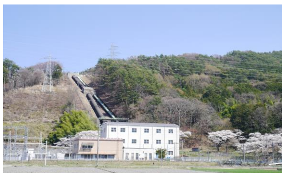
長野県企業局の春近水力発電所
