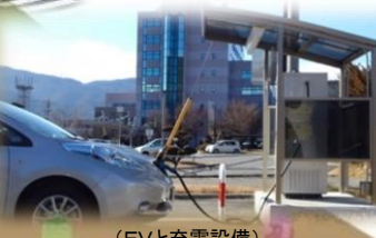
(EVと充電設備)
