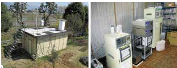
一般環境大気測定局の外観及び内部
