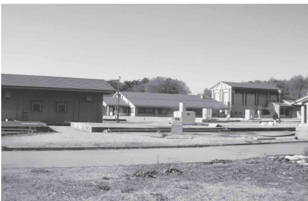
下水道処理施設の全景
