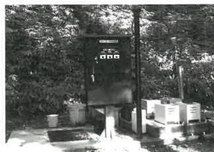
上高地の横尾山荘に設置されたし尿処理施設
