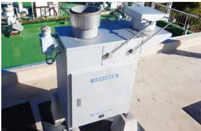
当所屋上に設置してある降水採取装置
