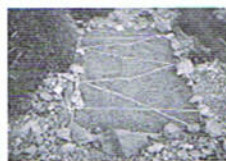
図 4. 植生復元工の例。裸地を麻製のネットで覆っている。ネットには、土壌の移動や流出を防ぐ効果があり、植生回復が促進される。
