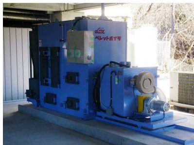
ペレットボイラー
