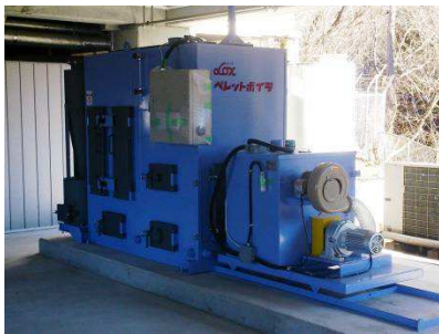
ペレットボイラー
