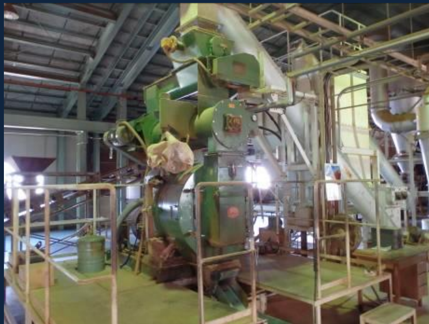
上伊那森林組合 バイオマスエネルギー工場
