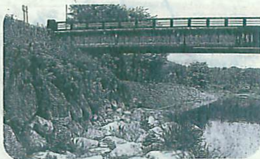
豪雨前の理兵衛堤防の様子 橋の下奥の堤防部分が流失して理兵衛堤防が出現した
