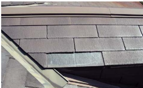
石綿含有住宅屋根化粧スレート
