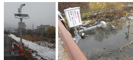
簡易型河川監視カメラ 危機管理型水位計
