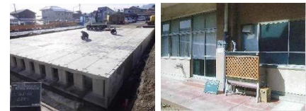
雨水貯留施設設置例(長野市豊野支所) 雨水貯留タンク設置例
