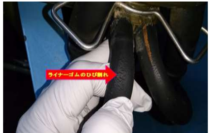
図-6 ライナーゴムのひび割れ
