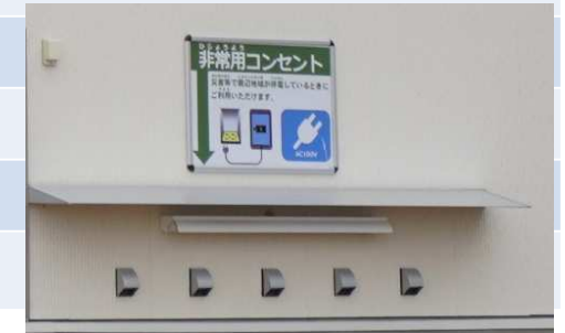
参考：小渋えんまん発電所 非常用コンセント
