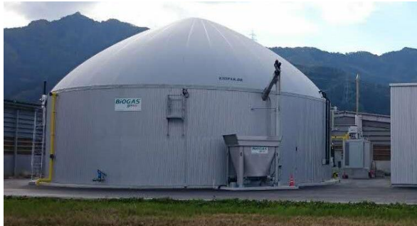
バイオマスガス発電所（中野市）
