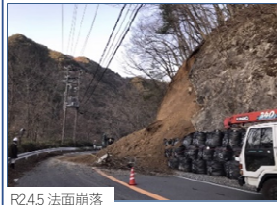
R245 法面崩落
