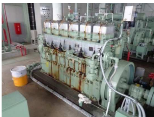
施設の老朽化状況
