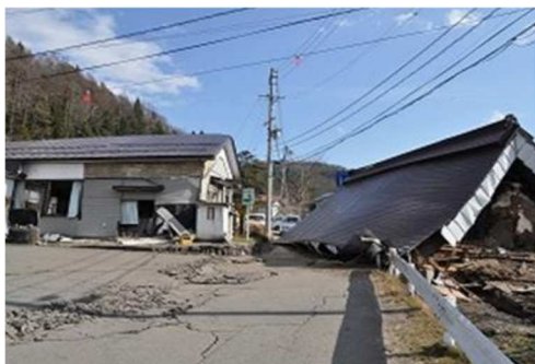
平成 26 年神城断層地震による民家等の倒壊 (出典：長野県耐震改修促進計画(第Ⅲ期)の概要)
