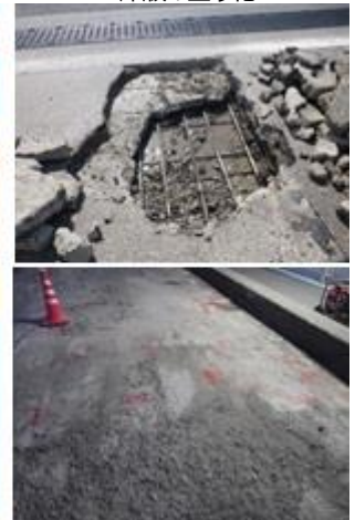
床版の土砂化
