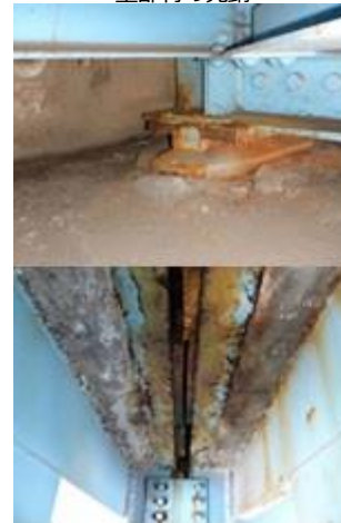
主部材の発錆
