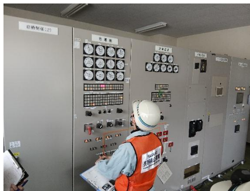
発電機の電圧・周波数を調整
