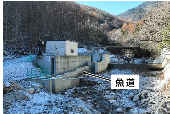
取水設備に設置した魚道
