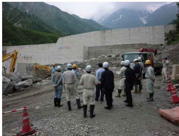
南股沢川 白馬村 南股（松本砂防事務所発注の砂防堰堤改築工事現場）
