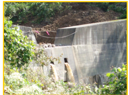
<11号堰堤に設置されている土石流センサー>
