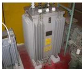
変圧器 (トランス)
