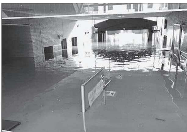
下水処理施設浸水
