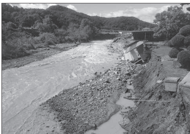
護岸損壊（佐久市）
