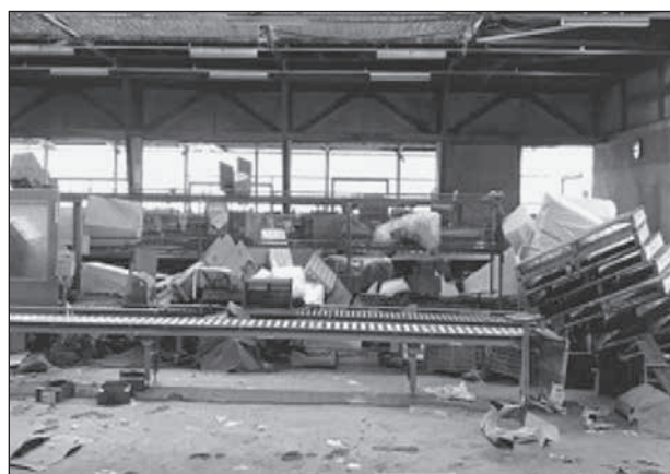
集出荷施設浸水
