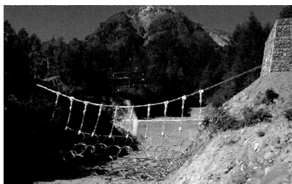
写真 9-4-10 強靱ワイヤネット砂防堰堤
