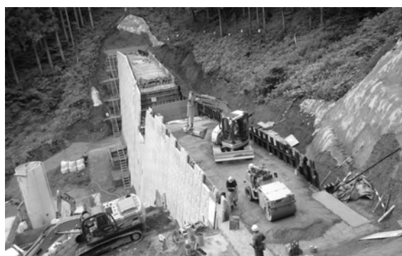
写真 9-4-12 砂防ソイルセメント砂防堰堤
