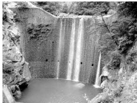
写真 1.3.3(b) アーチ式砂防えん堤
