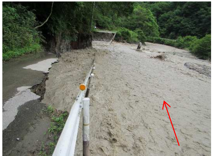
異常出水による兼用護岸欠損 (大鹿村 青木川)
