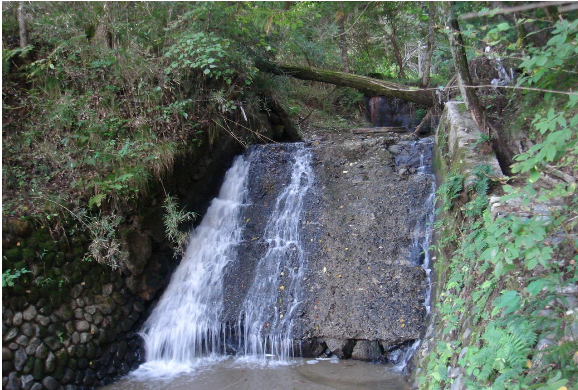
第5号と同じく昭和になってから上に コンクリートを張った第7号石張水路工
