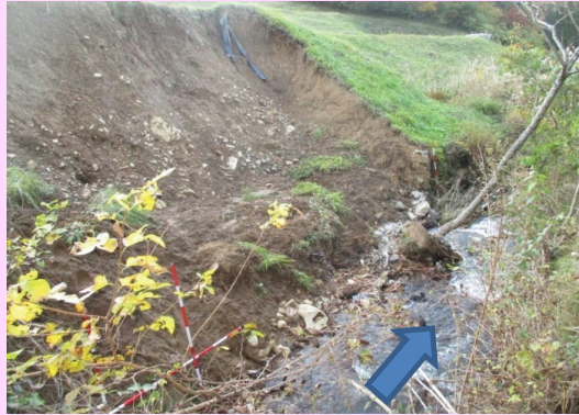
【長野市大岡 宮平】護岸の倒壊
