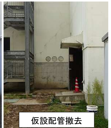
従来の仮設配管
