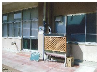
雨水貯留タンク設置例
