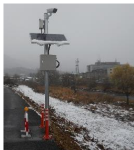
簡易型 河川監視カメラ
