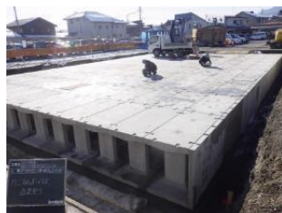
雨水貯留施設設置例 (長野市豊野支所)
