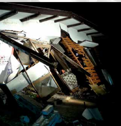
倒壊した家屋（白馬村堀之内区、北アルプス広域消防撮影）
