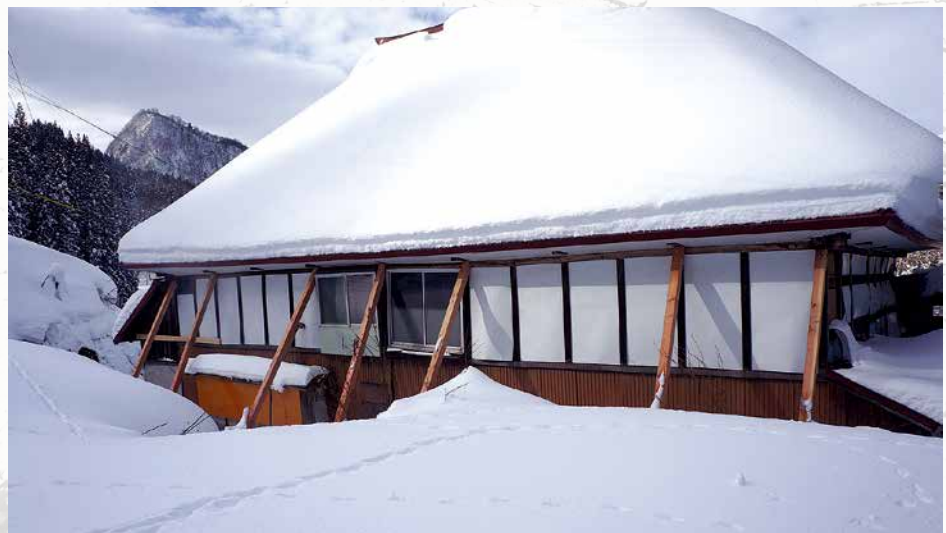
応急補強を施され、雪解けを待つ被災家屋（小谷村中土地区長崎集落）
