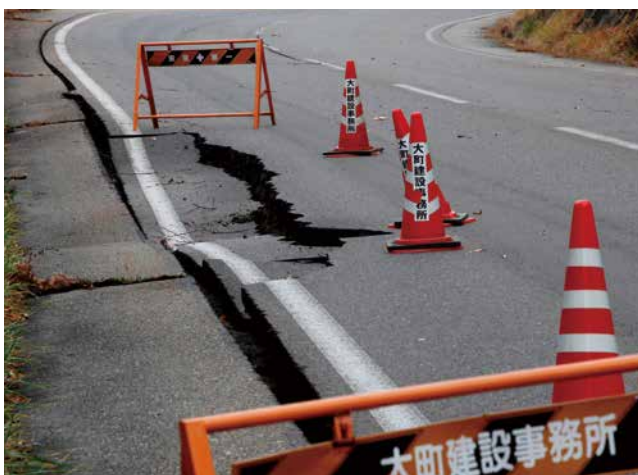
県道31号（長野大町線）の路肩陥没（『広報おおまち』緊急臨時号、平成26年11月30日）
