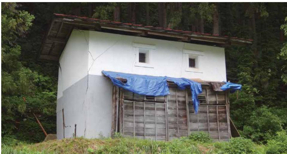
壁が大きくひび割れた土蔵(真木集落)
