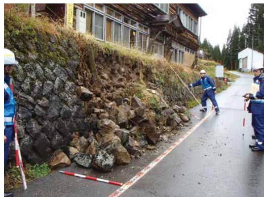
石積みが崩れた「カエルの学校」前の村道
