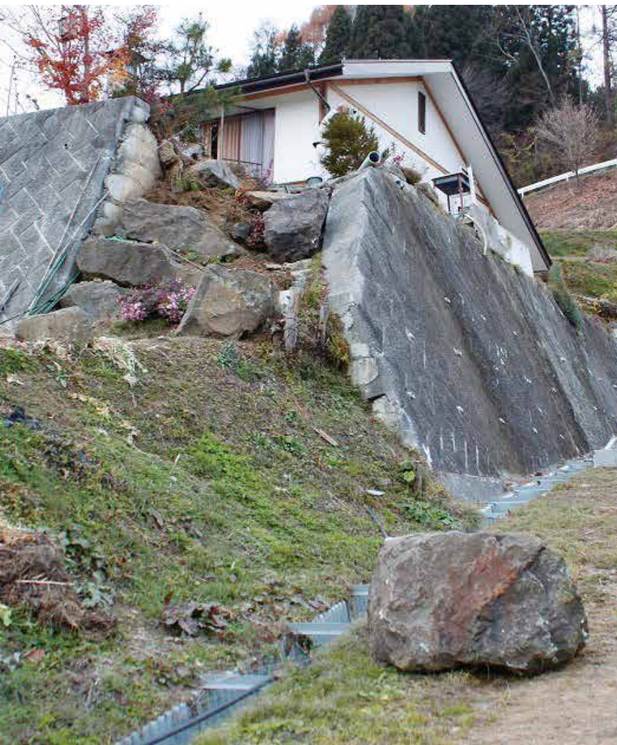
大きく破損した宅地のり面の擁壁(法地)
