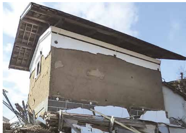
土壁が剥落した土蔵(鬼無里地区)
