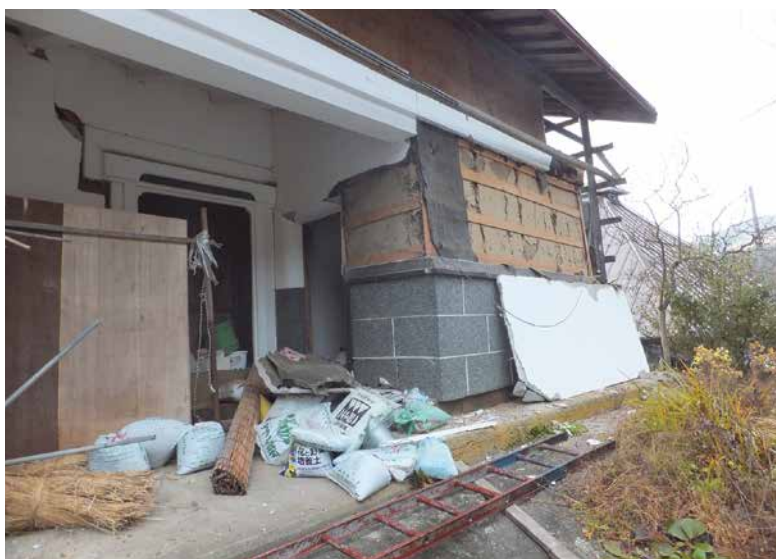
壁が崩れ落ち傾いた農家(青具米山)
