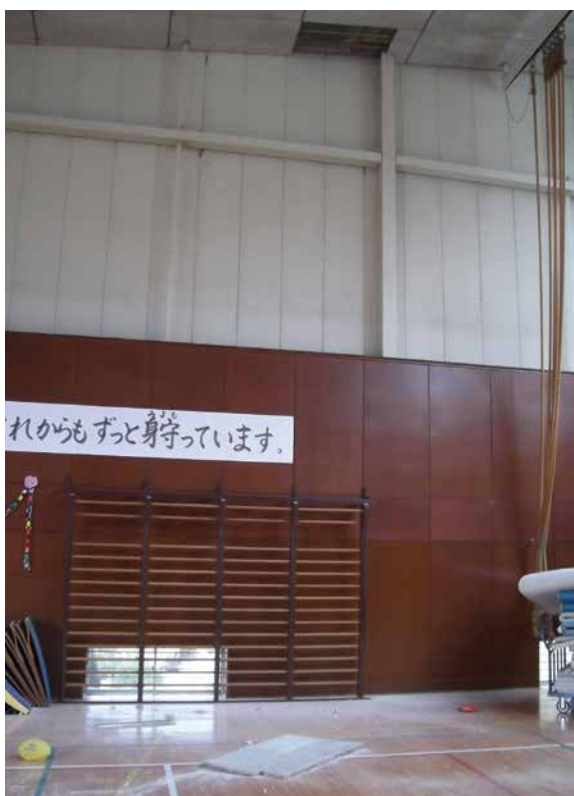
落下した小川小学校体育館の天井パネル(高府)
