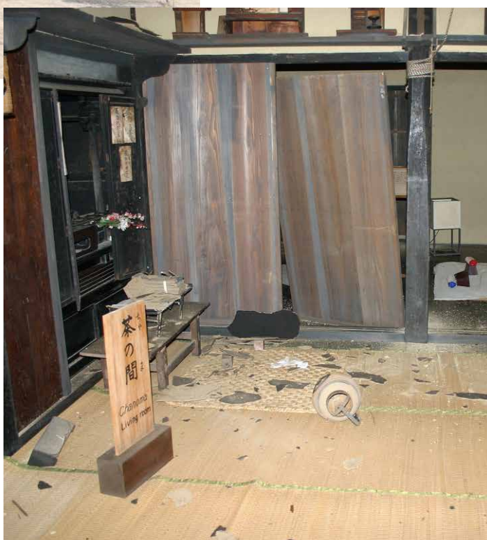
重要文化財・旧中村家住宅は主屋内部が激しく破損（『広報おおまち』緊急臨時号、平成26年11月30日）
