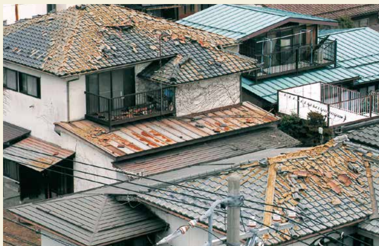
屋根瓦が破損した住宅(箱清水) (['信濃毎日新聞』平成26年11月24日)
