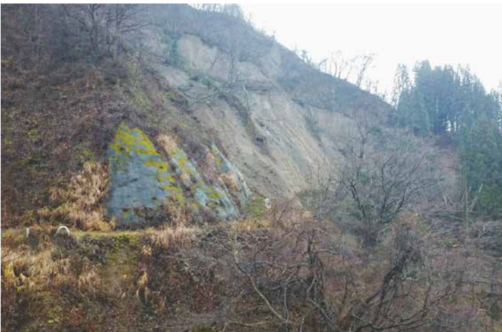
崩落した林道東山線
