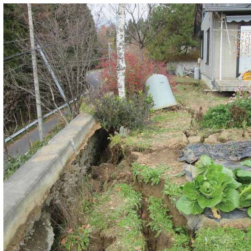
宅地の擁壁付近に深い亀裂(稲丘)
