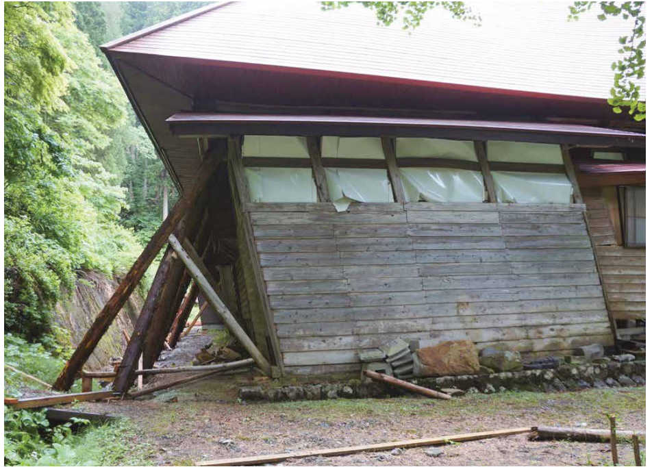
大きく傾いた玉泉寺本堂
