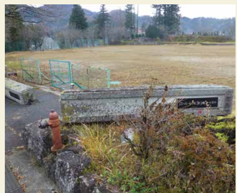
倒壊した鬼無里中学校の門柱
