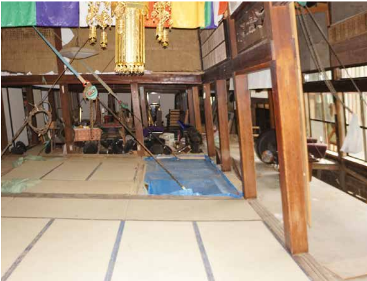
柱が傾き大きくゆがんだ玉泉寺本堂内部
