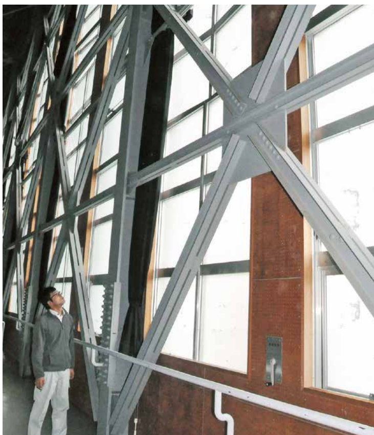
窓ガラスが割れ、使用中止となった町総合体育館 （『信濃毎日新聞』平成26年11月28日）
