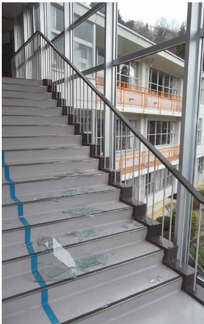
小川小学校渡り廊下の窓ガラスが破損
