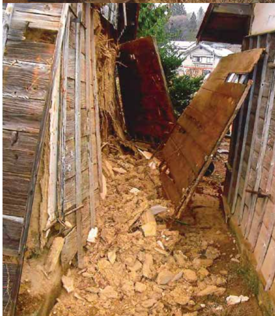
崩れ落ちた土蔵の壁
