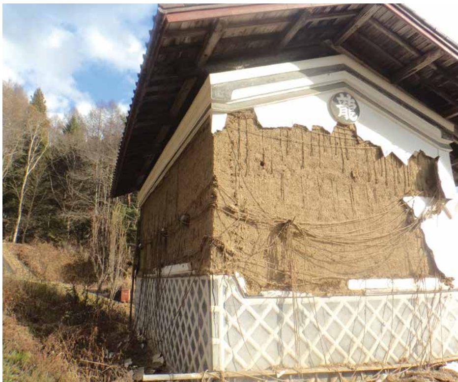
白壁が剥がれ落ちた土蔵(青具地区)
