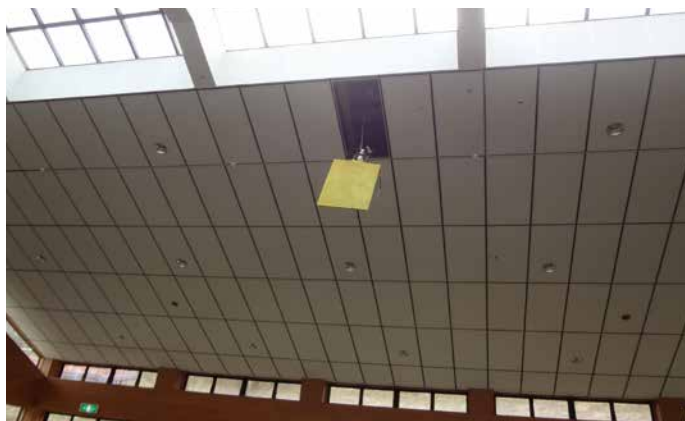
「ぼかぼかランド美遊」の附属施設では、天井のパネルが落下（『広報おおまち』緊急臨時号、平成26年11月30日）
