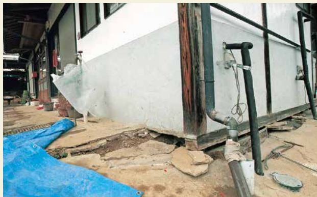
外見上大きな被害は分からないが、基礎部分を損傷しているため「二次調査」で「全壊」と判断された住宅(瀬戸川) (『信濃毎日新聞』平成26年12月6日)
