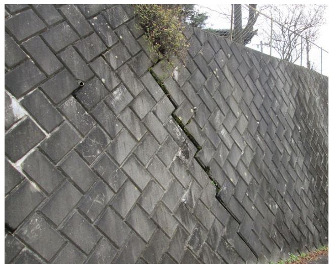
上野(高府)では村道のり面擁壁に大きな亀裂
