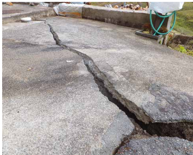
庭先のコンクリートにも亀裂(青具塩ノ川)
