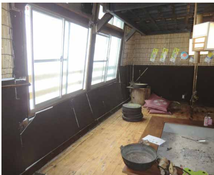
壁面が破損した「カエルの学校」の内部
