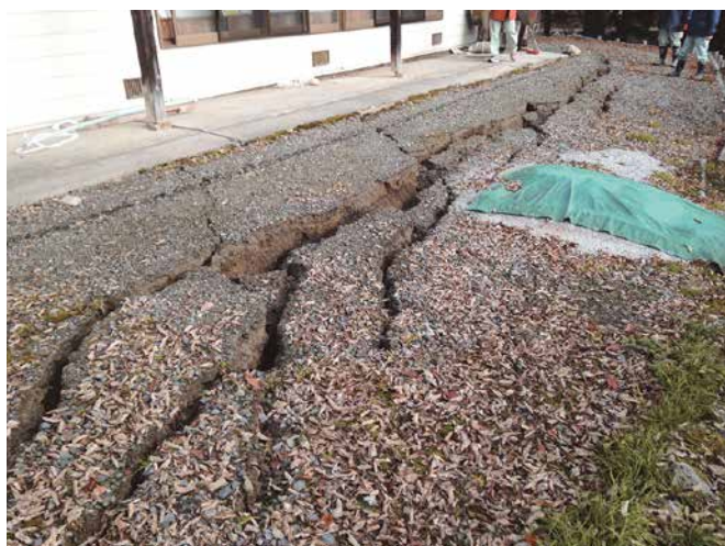
宅地に生じた地割れ(青具峠)
