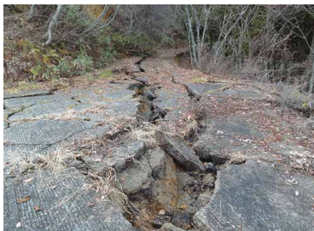
路面に大きな損傷を受けた市道矢久川手線
