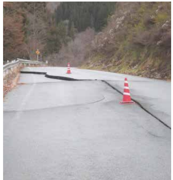
鬼無里側の県道36号(信濃信州新線)に大きな亀裂
