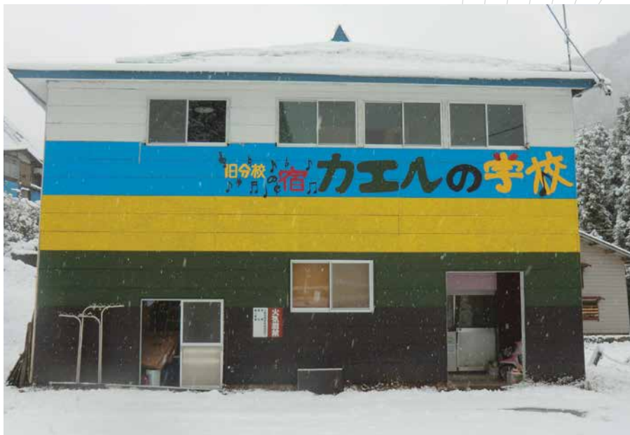
建物が傾くなどの被害を受けた旧中土小学校真木分校の校舎を利用した宿泊施設「カエルの学校」(その後取り壊された)
