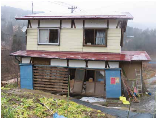
全体にゆがんだ民家(長崎集落)
