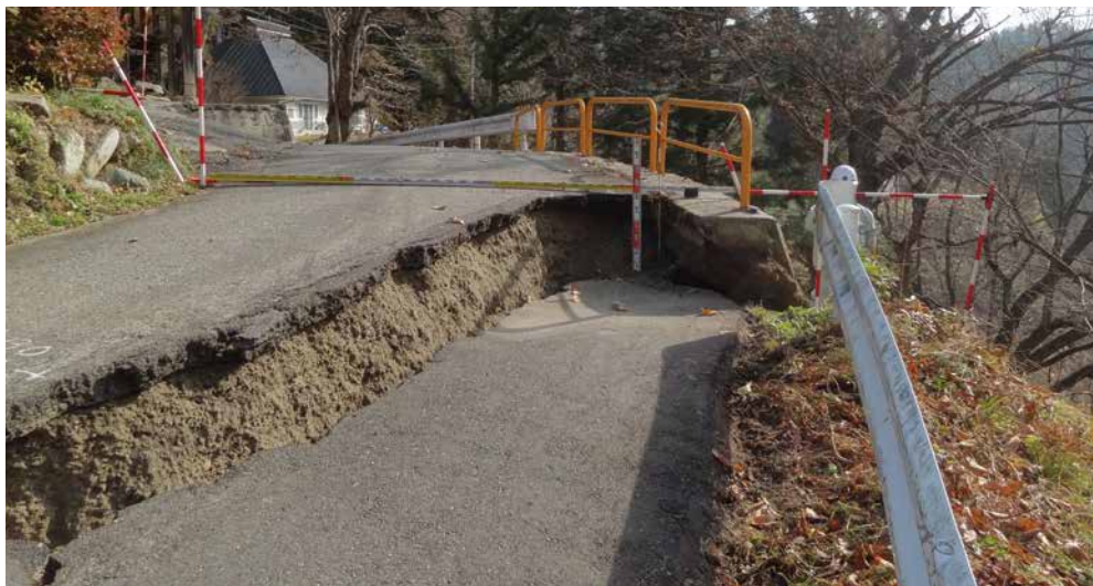
市道石原線では大きく道路が決壊（『広報おおまち』平成27年1月号）
