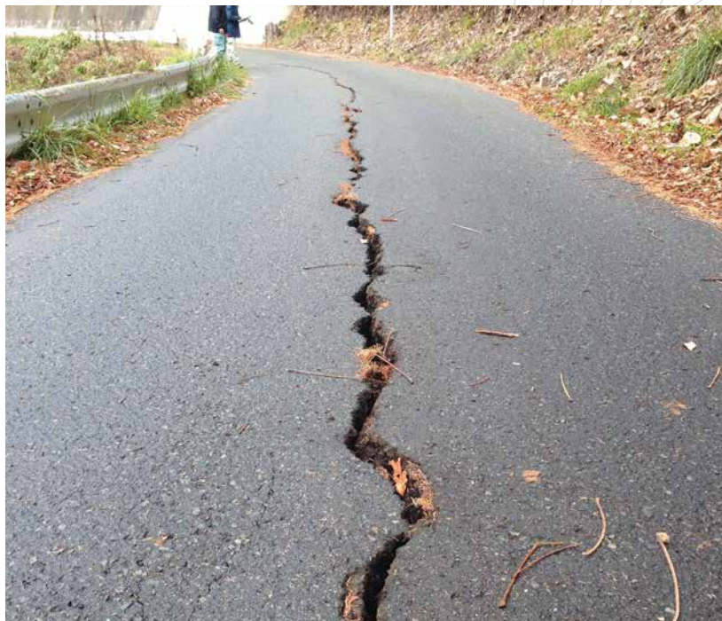
県道453号（飯綱高原芋井線）では道路の中央に亀裂が出現
