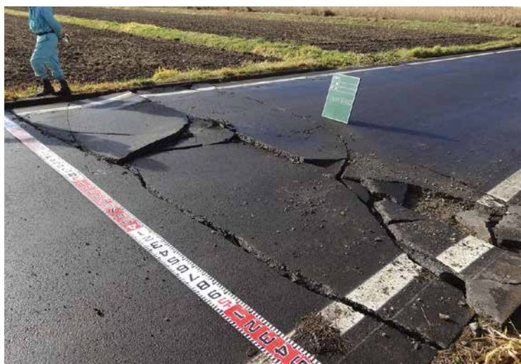
農道に複数の亀裂（富士里地区）
