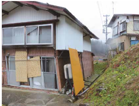
著しく傾いた民家(長崎集落)
