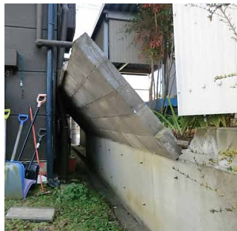
倒壊したブロック塀(箱清水)
