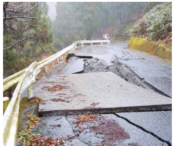
路面が大きく損傷した村道梨平線
