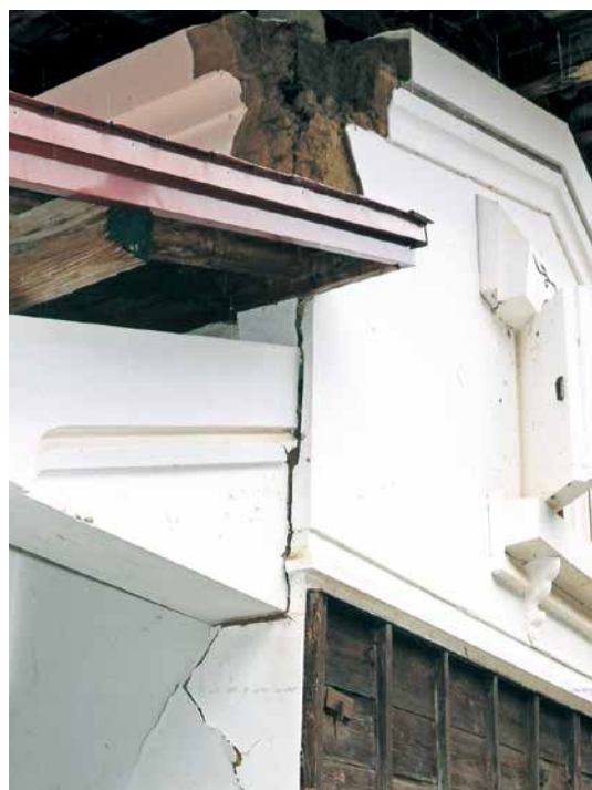
小谷温泉の老舗・山田旅館の土蔵(登録有形文化財)に、壁の一部が落ちるなどの被害が出たが、営業は継続(『信濃毎日新聞』平成26年11月27日)
