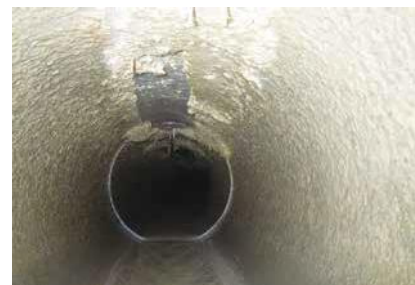
下水道管渠内の付着物 清掃前
