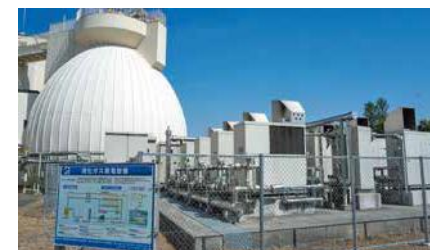
消化ガス発電設備
