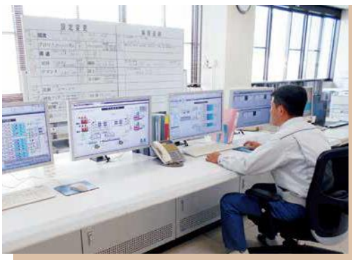
中央監視室では、モニター画面を通して監視しています。
