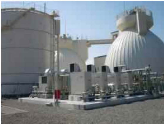
消化ガス発電施設稼働。 処理場維持管理費用の縮減と温暖化対策に貢献
