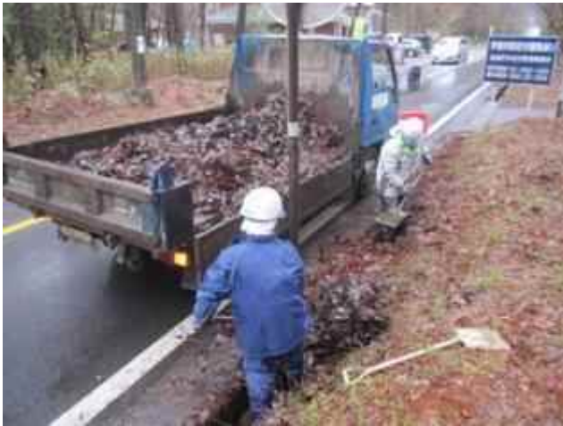
新たに始まった道路補修工事の民間委託による維持補修（側溝清掃）
